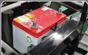
Batería de libre mantenimiento y ubicada en zona segura.
